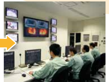
現地中央制御室
