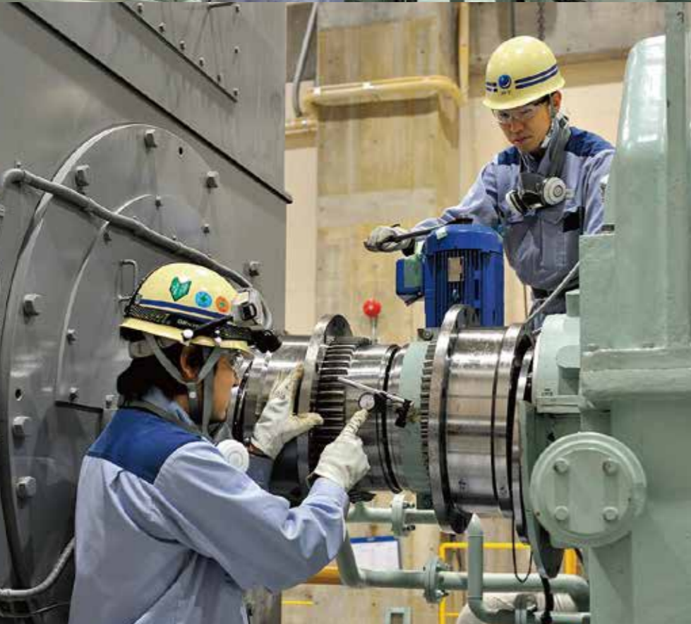
◀ Alignment check 蒸気タービン 発電機 軸心確認
