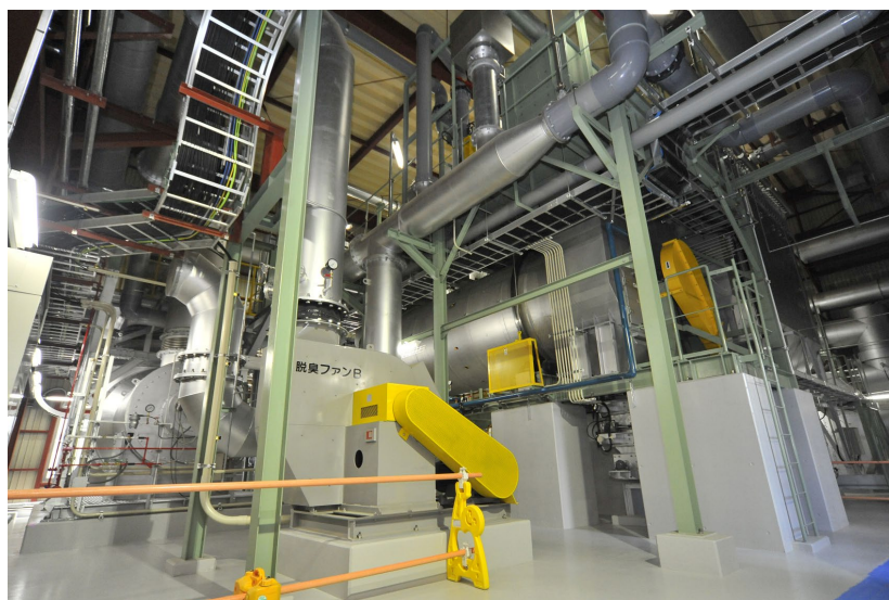
□脱水汚泥乾燥処理プラント
