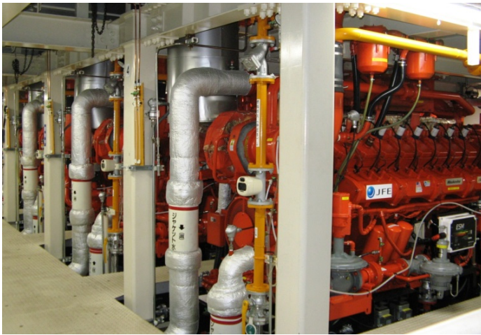
□岩崎コンピューターセンタービルに納入された高効率ガスエンジン
