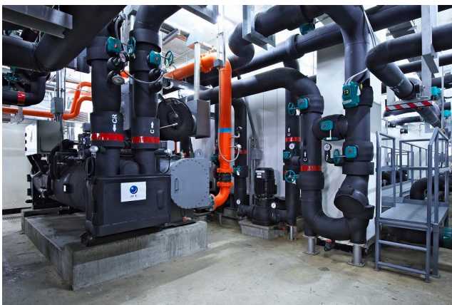
■ 完成したネオホワイト蓄冷の空調設備
