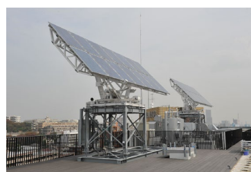
太陽光発電（屋上）
