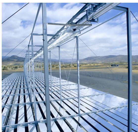
タワー型太陽光発電設備（CPV）（写真上）とリニアフレネル型太陽熱発電
