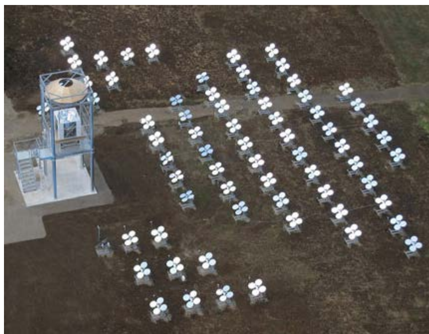
試験設備全景
