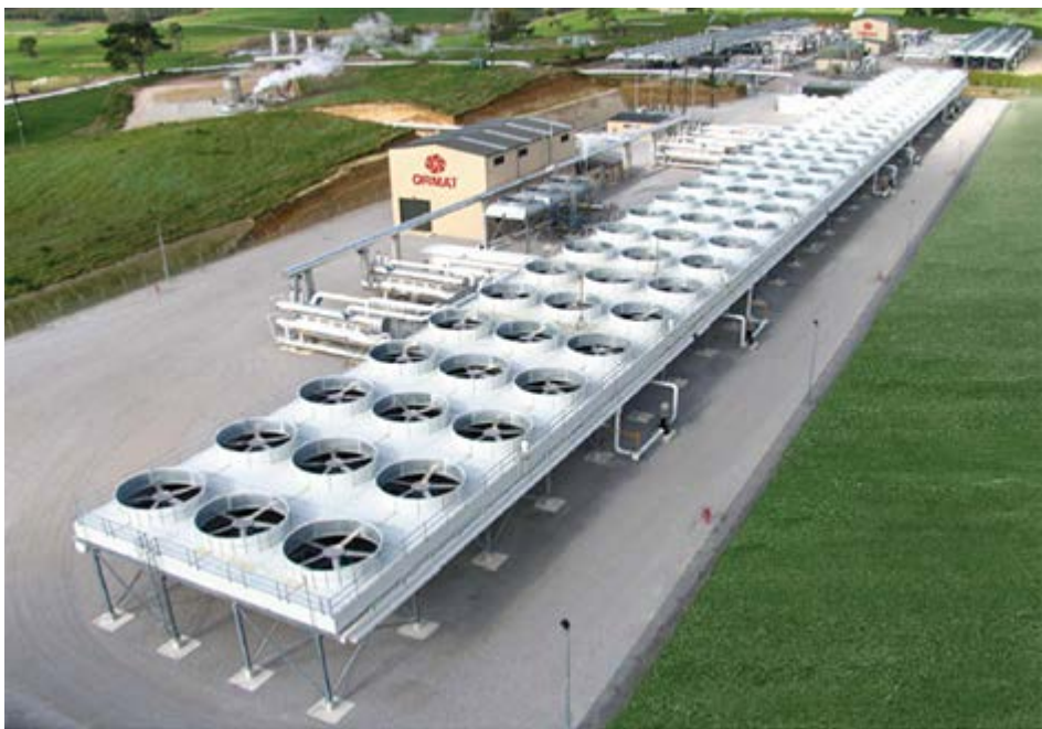
ニュージーランド モカイ地熱発電所 出力125MW
